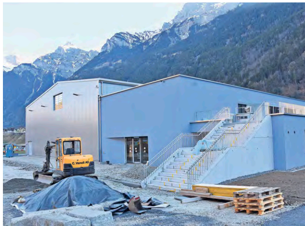
Im Grund in Amsteg entsteht das Sport- und Ärztezentrum, in dem auch ein Restaurant untergebracht ist.
