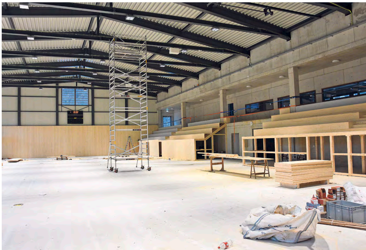
Aktuell wird in der Dreifachsporthalle an den Tribünen (rechts im Bild) gearbeitet. Ab Anfang Juni soll hier bereits Unihockey gespielt werden.
